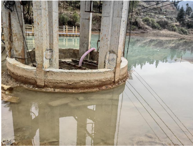
图 2.6-7 株梓洞尾矿库库内 4 号排水井
