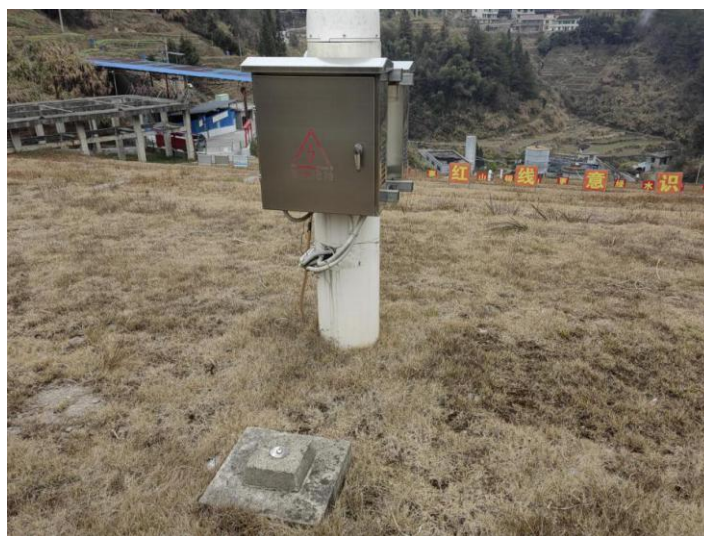
图 2.6-14 株梓洞尾矿库坝体表面位移监测设施
