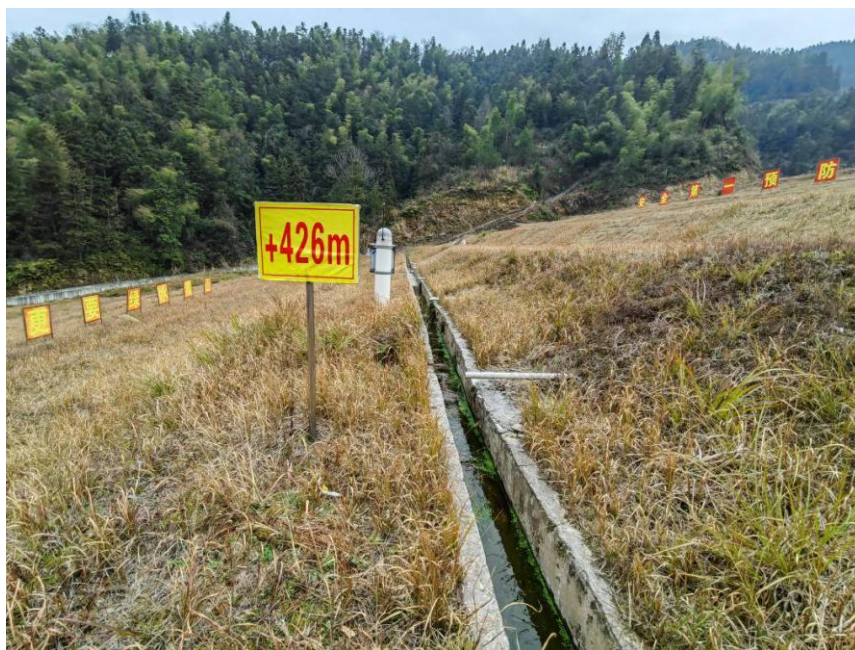
图 2.6-17 株梓洞尾矿库排渗设施
