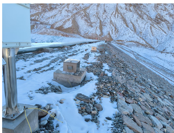
图 2.5-17 初期坝监测设施
