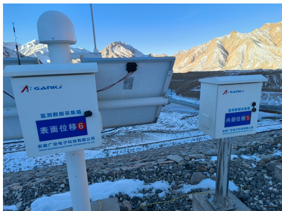
图 2.5-14 位移监测设施
