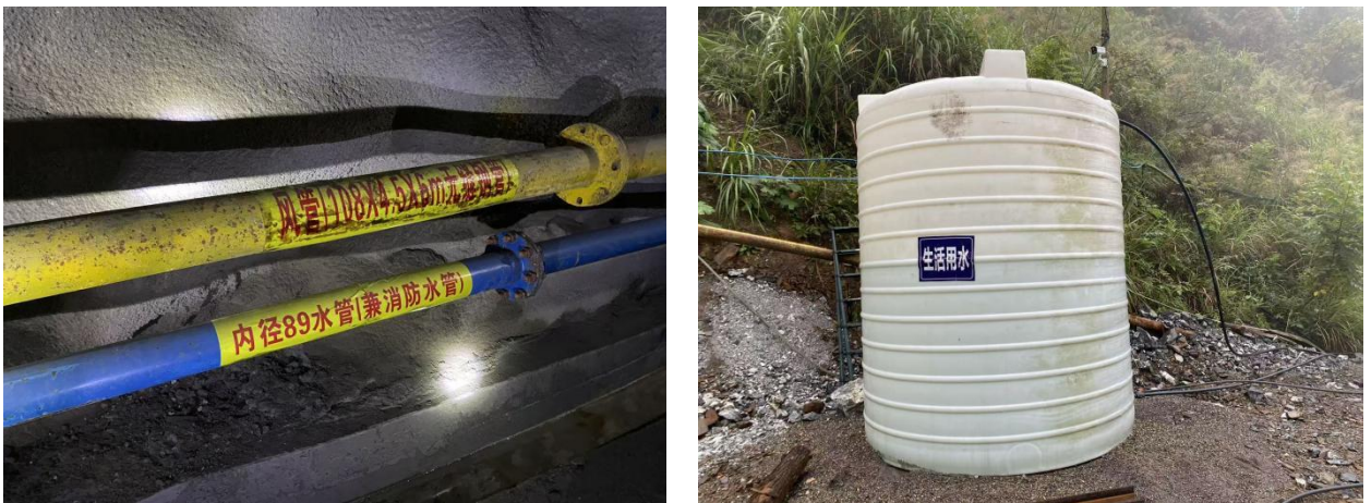
图 2-20 供水管及生活水箱
