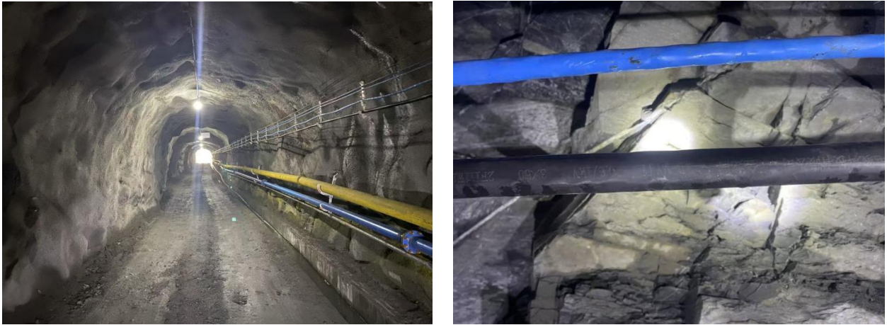
图 2-22 电缆安装现状
