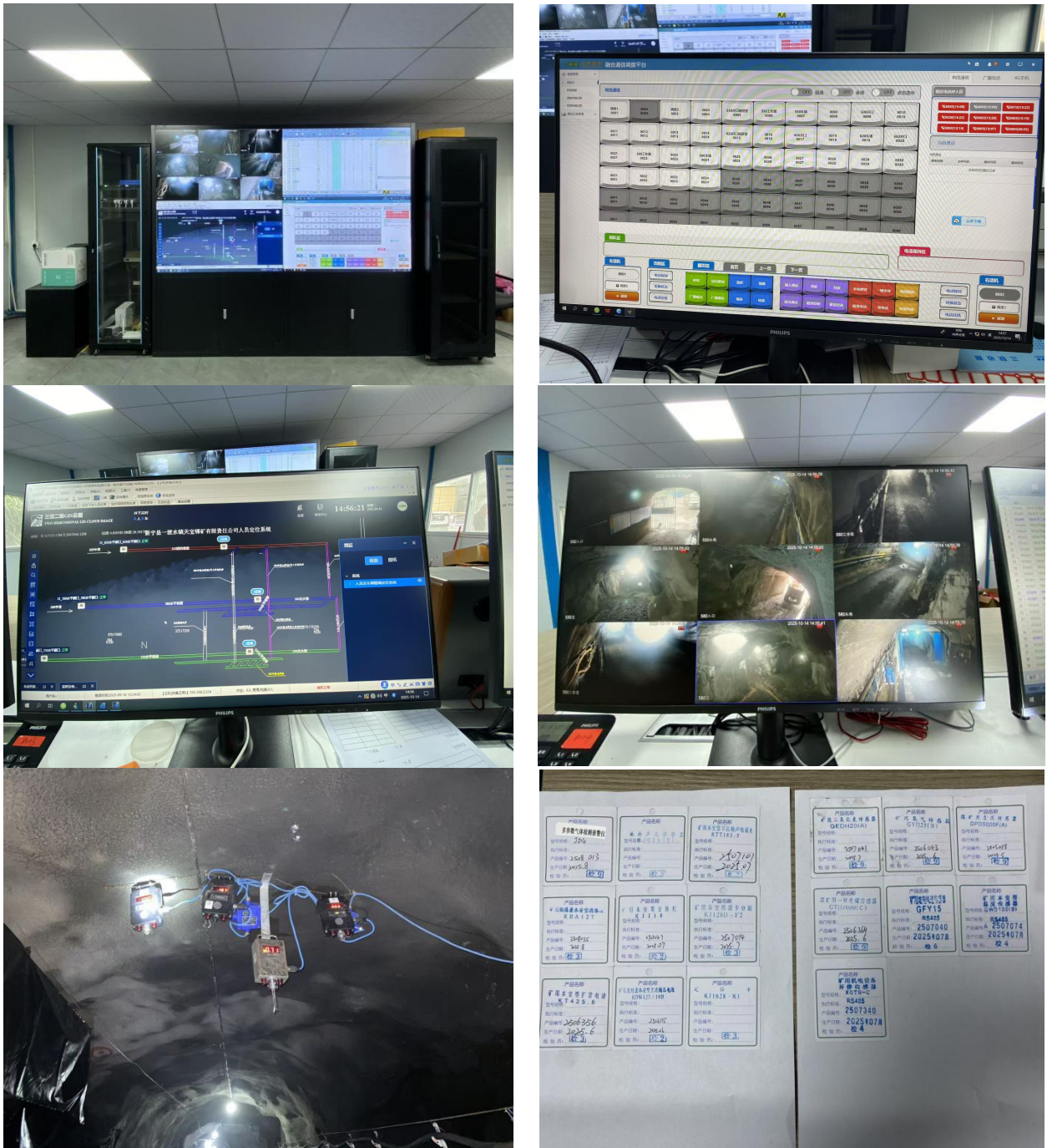
图 2-22 数据中心、控制中心和井下安装情况
