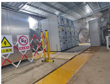
图 2-42 +700m 中段 1 号变配电硐室
