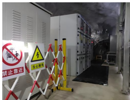
图 2-43 +700m 中段 2 号变配电硐室
