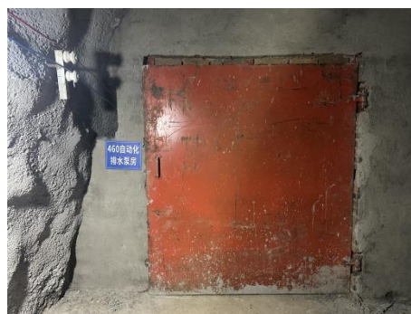
图 2-33 +460m 水泵房防水门
