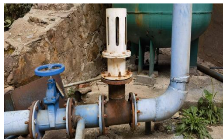
图 2-37 储气罐安全阀
