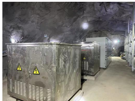
图 2-41 +460m 配电房内部
