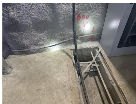
图 2-47 +460 配电房电缆沟
