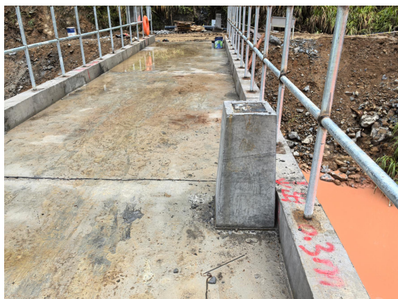
图 2.5-22 截渗坝处监测设施
