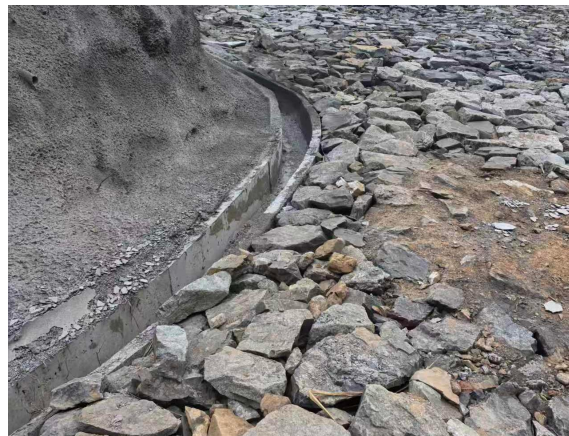
图 2.5-5 初期坝右坝肩截水沟
