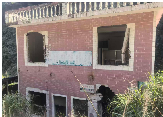
图 2.4-3 居民搬迁后的房屋
